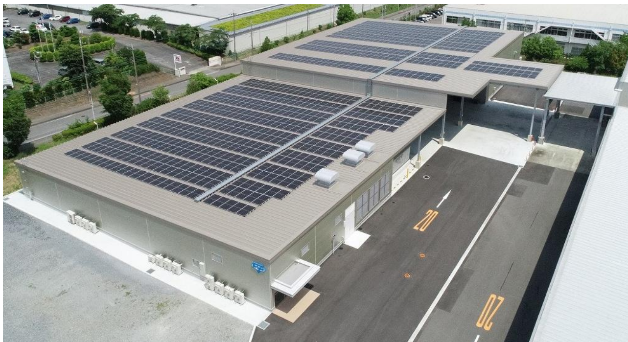
吉見工場テクノ & ロジセンターに設置した太陽光パネル
